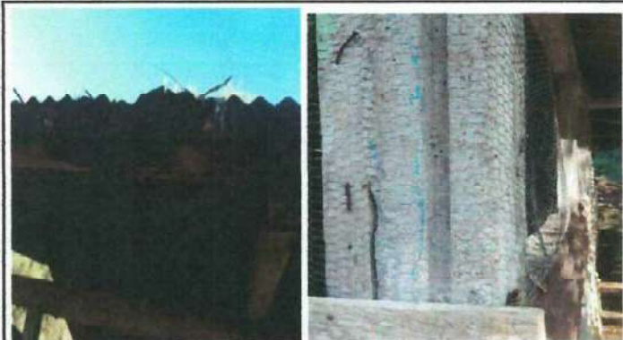
Foto1: Se necesita reforzar la cocina levantamiento de 5 hiladas de blok, y culminación de maya galvanizada, lo cual ya cuenta con parales de concreto, sustitución de cubierta de lamina, y estructura de techo
