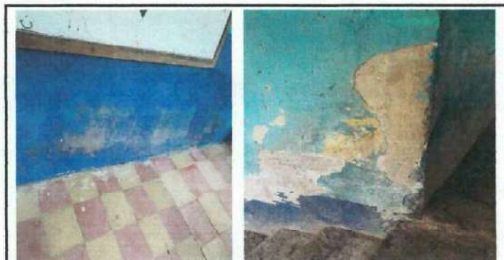
Foto 6: se necesita dar mantenimiento repello en paredes interior y exterior
